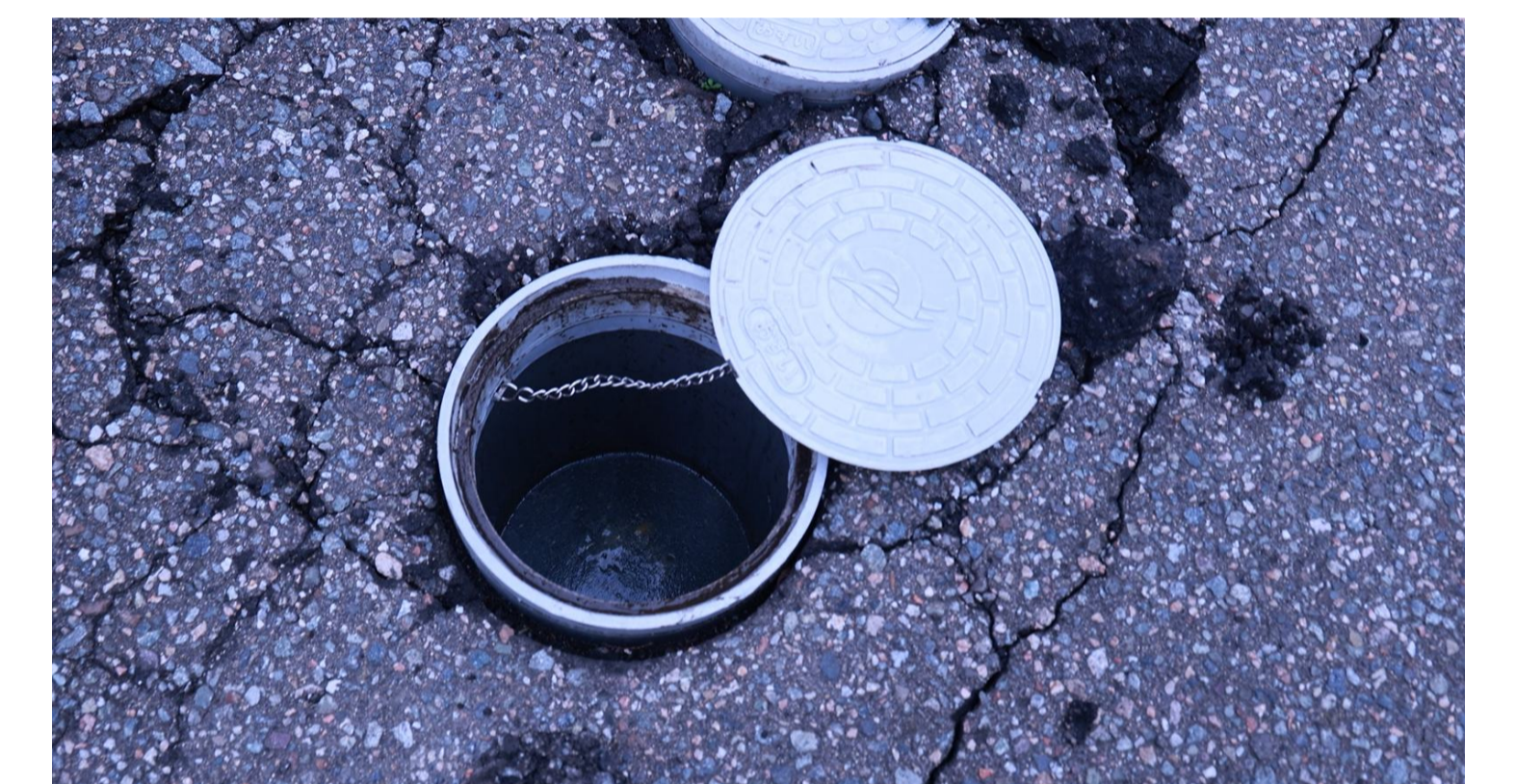
“汚水ます”で下水が流れていないことが確認できる “Sewage inlet” confirms that sewage water is not flowing.
